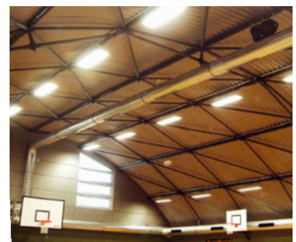
Gymnase de Winzerla - Allemagne, Profil ondulé Aluform 55/177 perforé et bombé à fibre acoustique
