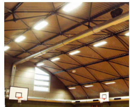
Turnhalle Winzerla - Deutschland, Aluform Wellprofil 55/177 gelocht & bombiert mit Akustikvlies
